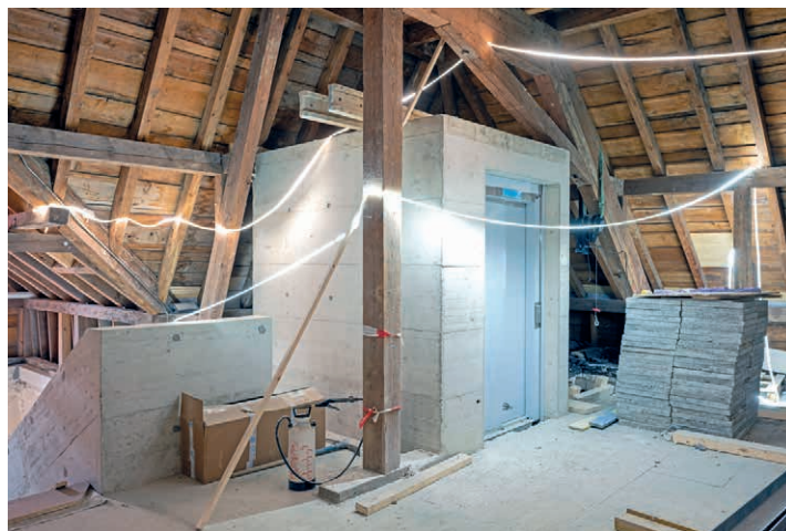
L'intérieur du bâtiment principal, en pleine rénovation, connaît des innovations audacieuses, comme l'installation d'un ascenseur. MARC RENAUD
